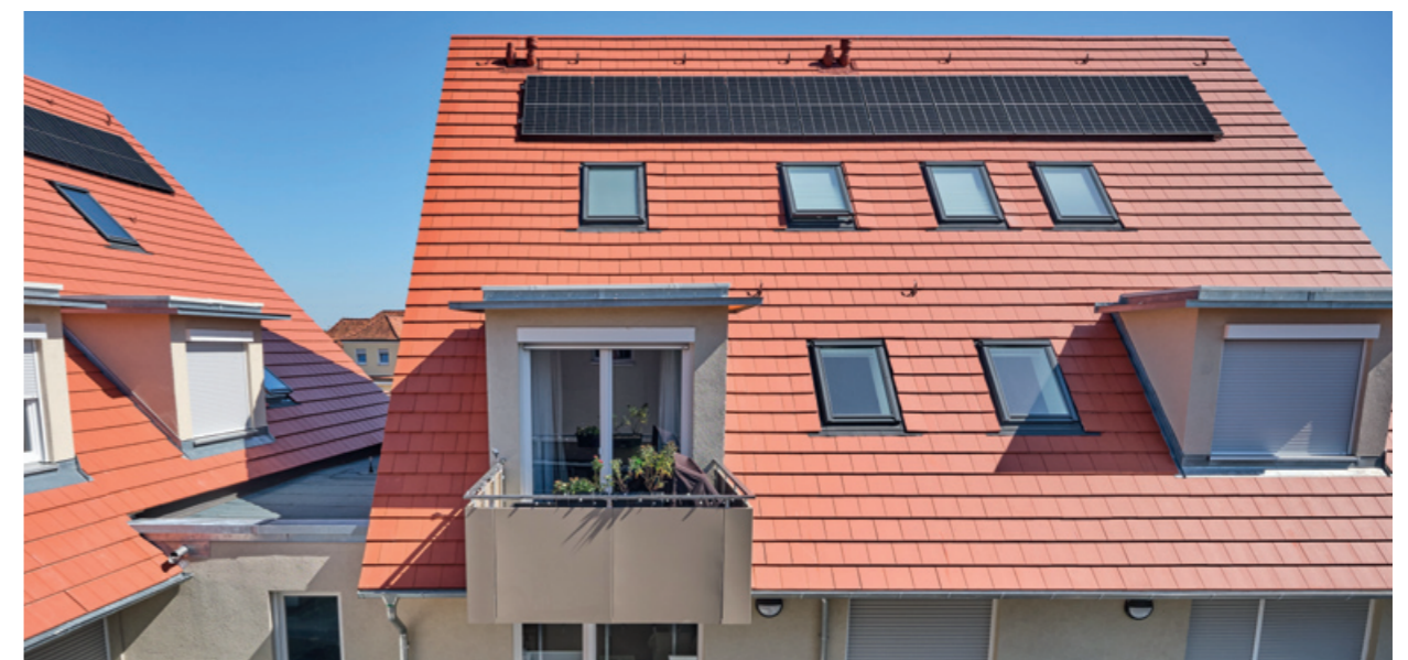
Bild: WI 66 Beispiel Photovoltaikanlage
